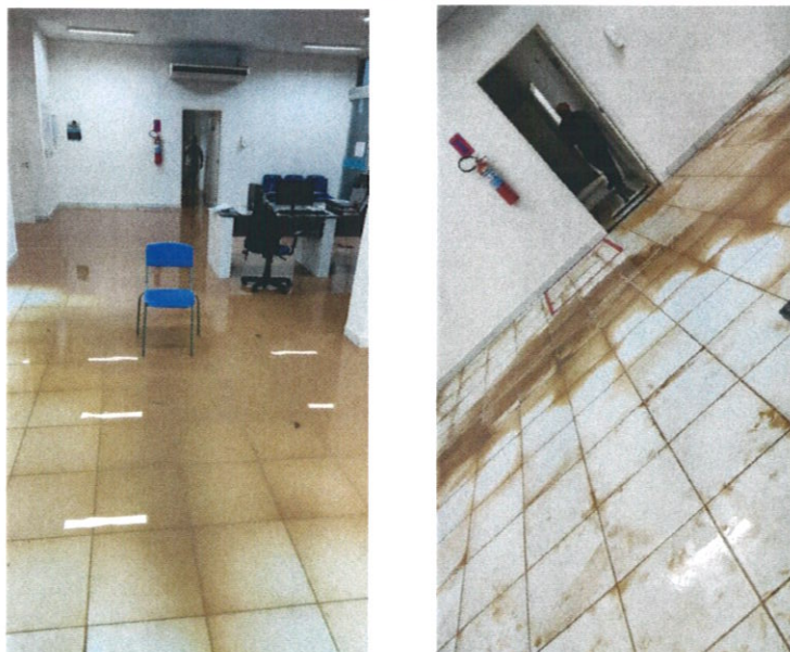
FOTO 1: Alagamento das chuvas do dia 22/06/2022.
