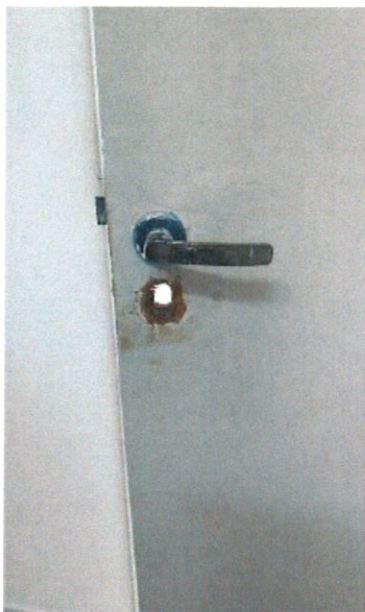
FOTO 18: maçaneta e portas danificadas.
