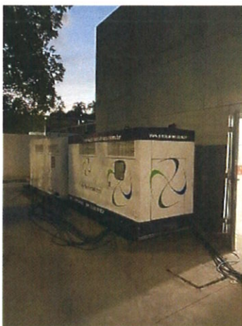
FOTO 1: Localização dos geradores no CPN
