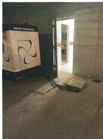
FOTO 2: Instalações dos geradores no CPN
