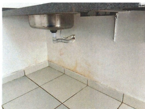
FOTO 8: Infiltração sala de acompanhantes
