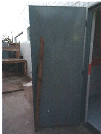
FOTO 27: Estruturas das portas quebradas e sem fechamento
