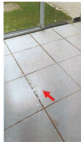
FOTO 7: Infiltração em quarto PPP
