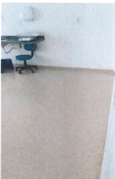
FOTO 22: PPP 06 sem banheira instalada
