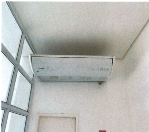
FOTO 24: ar condicionado sem funcionar
