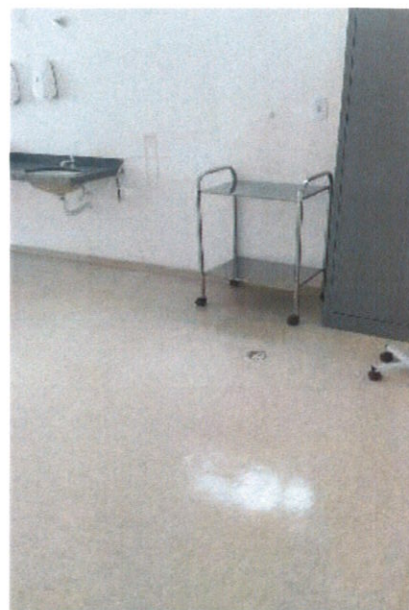
FOTO 23: PPP 03 sem banheira instalada
